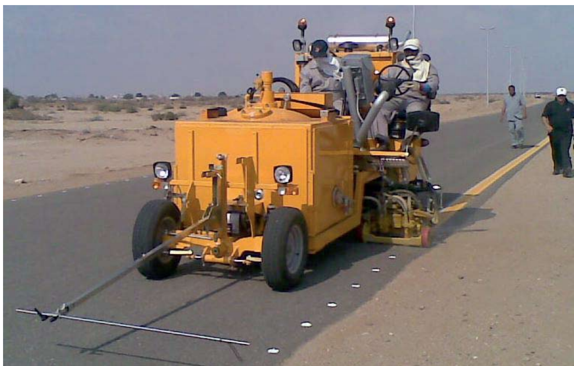
Nach einer kurzen Schulung mit dem Serviceteam von Borum hat Al Owaidah in Jizan, unweit der saudisch-jemenitischen Grenze, inzwischen ein prestigeträchtiges Straßenmarkierungsprojekt fertig gestellt.
